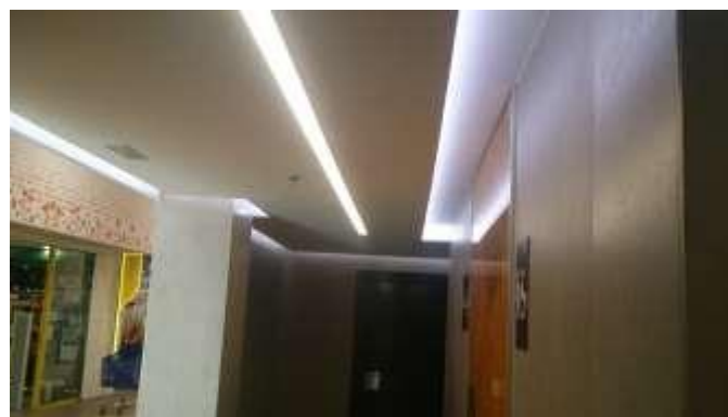
Instalación realizada para centro comercial en Elche
